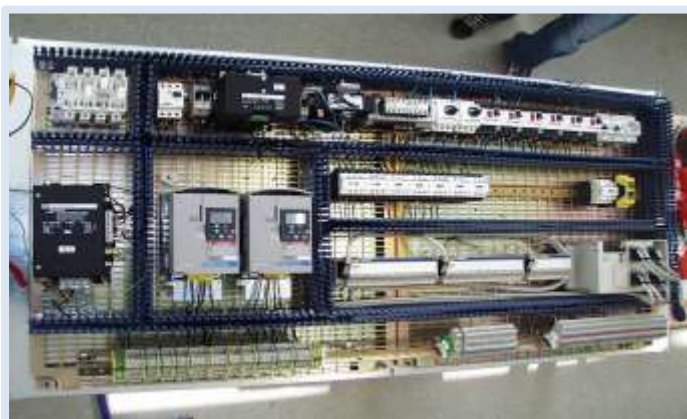
Câblage d'armoire de machine spéciale
